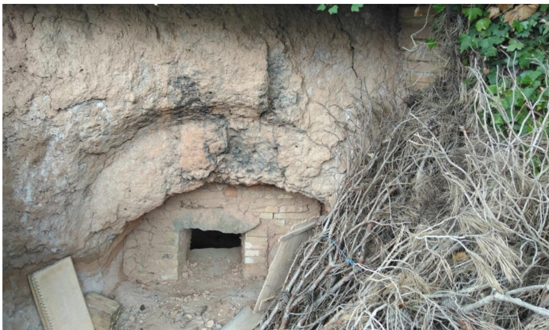
Boca d'alimentació de la cambra de foc de la teuleria de Cal Plaxats
